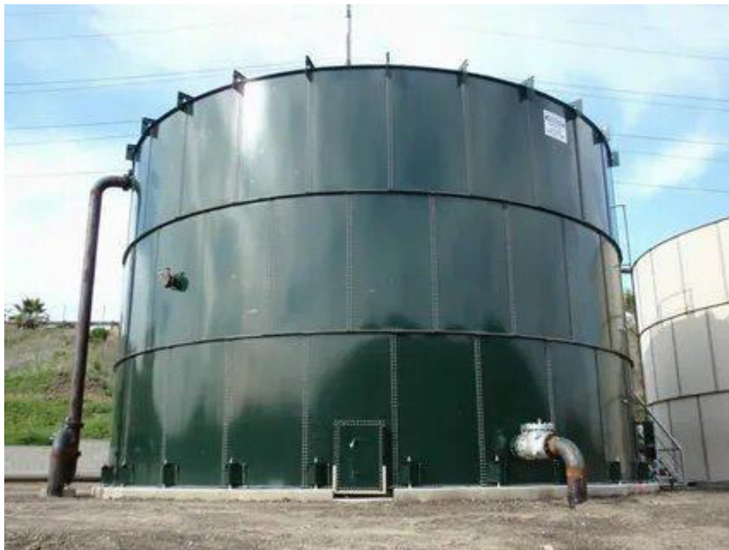
Рис. 3. Резервуар для хранения нефтешлама
