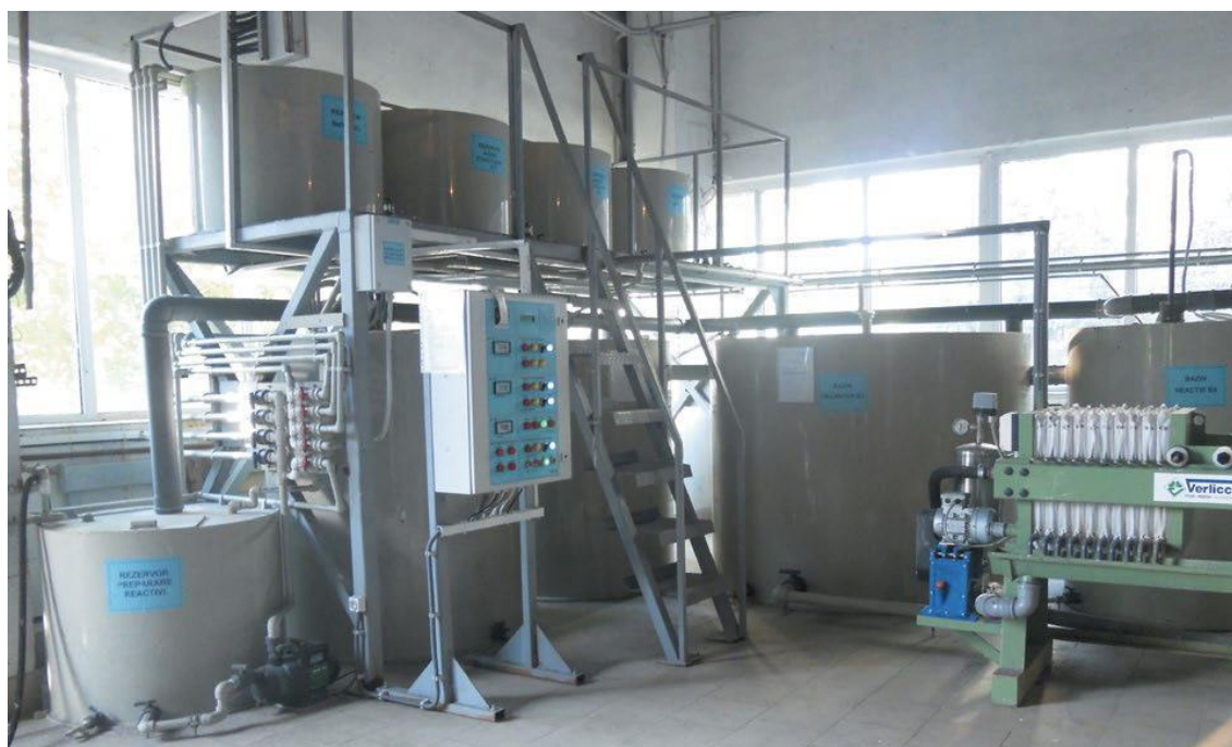
Рис. 12. Установка для нейтрализации щелочи
